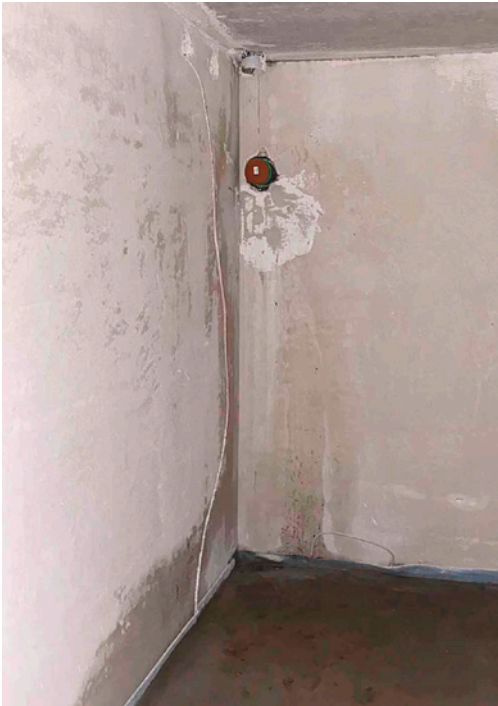
Abb. 01: Kelleraußenwand mit Wasserablaufspuren unterhalb einer Wanddurchdringung
