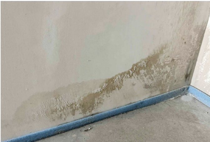
Abb. 07: Kellerwand mit Wasserrändern und Salzausblühungen
