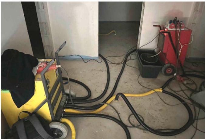
Abb. 05: Trocknungsanlage in einem Kellerraum
