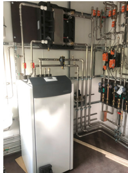
Abb. 02: Wärmepumpe im Energiecontainer [Foto: Ulrich Lüdersen]
