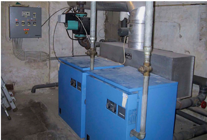
Abb. 02: Bestehende Heizungsanlage mit Konstanttemperaturkessel
