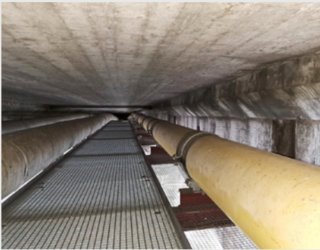
Abb. 01: Gasleitung DN 300 im begehbaren Brückenkörper (Gitterroste) [Foto: Netze BW GmbH]
