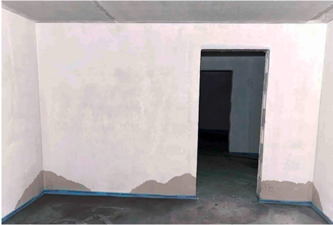
Abb. 02: Durchfeuchtung am Fußpunkt einer Kellerinnenwand
