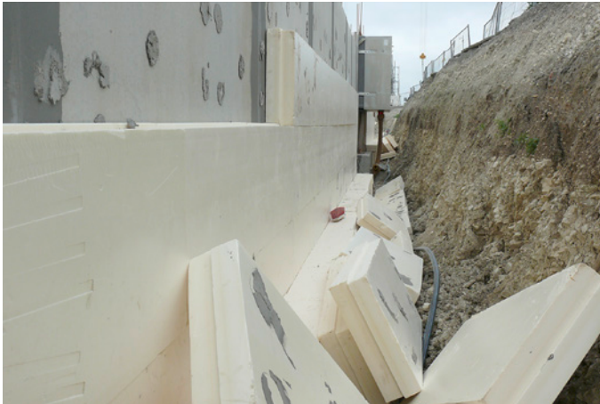
Abb. 03: Punktweise verklebte und von der Kelleraußenwand abgelöste Perimeterdämmung
