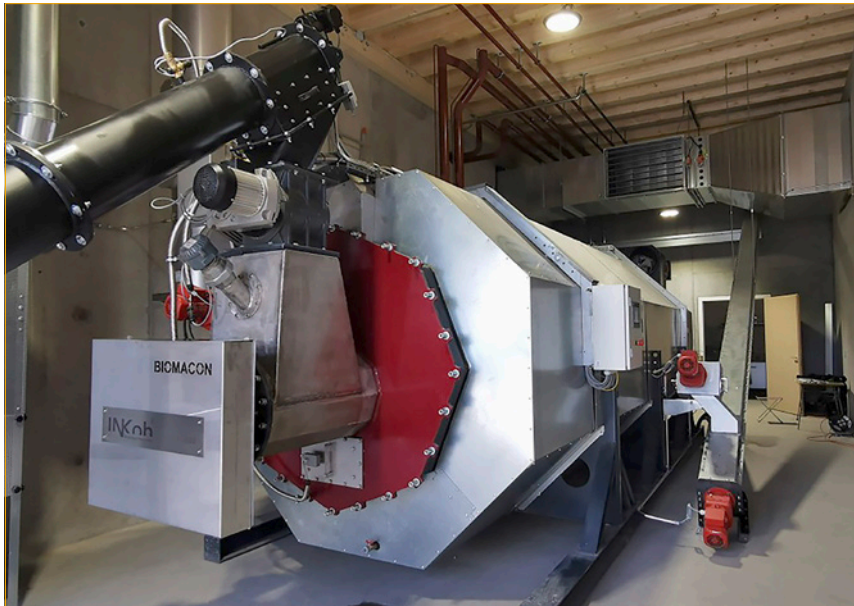
Abb. 01: BioMACON Pyrolyseanlage [Foto: Zindel United]
