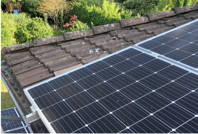
Abb. 01: Teil der PV-Anlage auf dem Hauptdach
