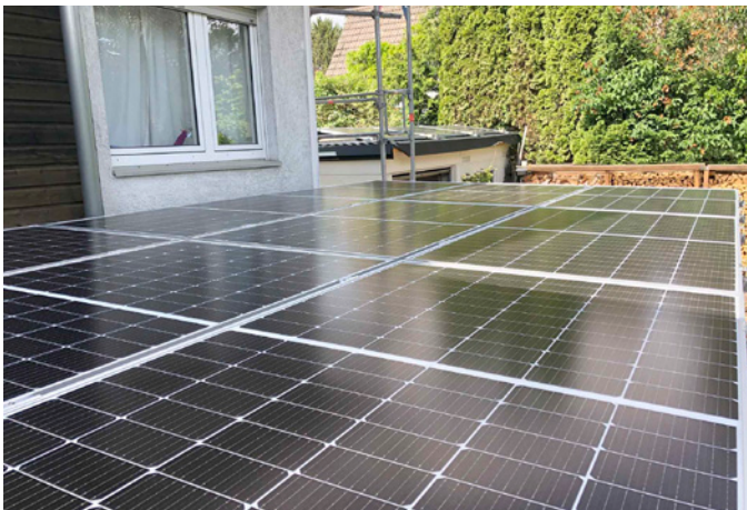
Abb. 02: PV-Anlage auf einem Nebendach
