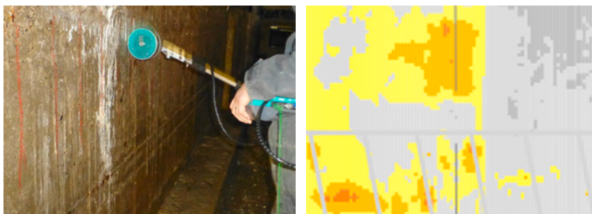
Abb. 07: Potentialfeldmessung an einem Wandssockel, Potentialkarte zur Abgrenzung von Bereichen hoher (rot-orange) und geringer Wahrscheinlichkeit aktiver Korrosion (grau) [Quelle: Dr.-Ing. Sebastian Schulze, bauray GmbH/hupfer ingenieure]
