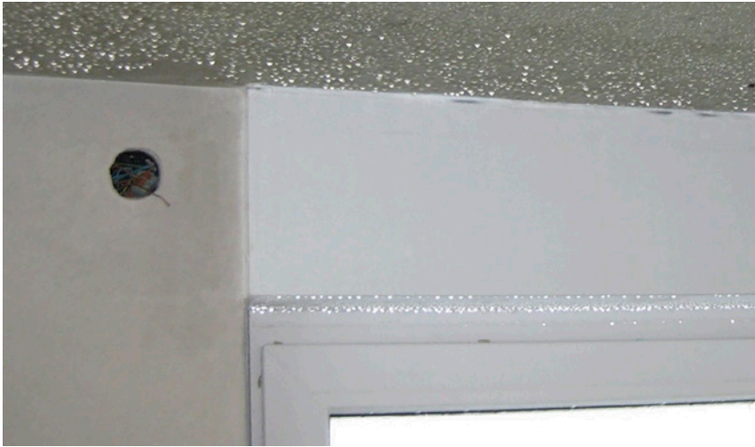
Abb. 07: Auffeuchtung der Innenluft durch Neubaufeuchte [Foto: Studie zum Lüften im Wohnungsbau]
