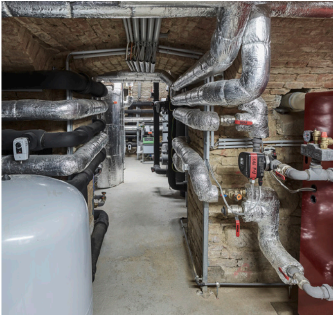
Abb. 02: Hautechnikzentrale im Bestandskeller [Foto: Kurt Hoerbst]
