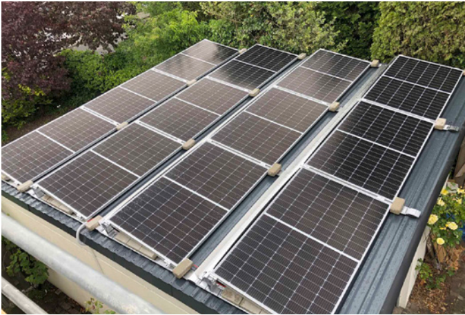
Abb. 03: PV-Anlage auf dem Garagendach
